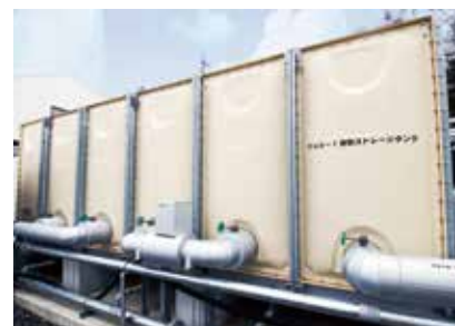
排温水は一旦このストレージタンクに集められヒートポンプ側に送り込む流量を調整する
